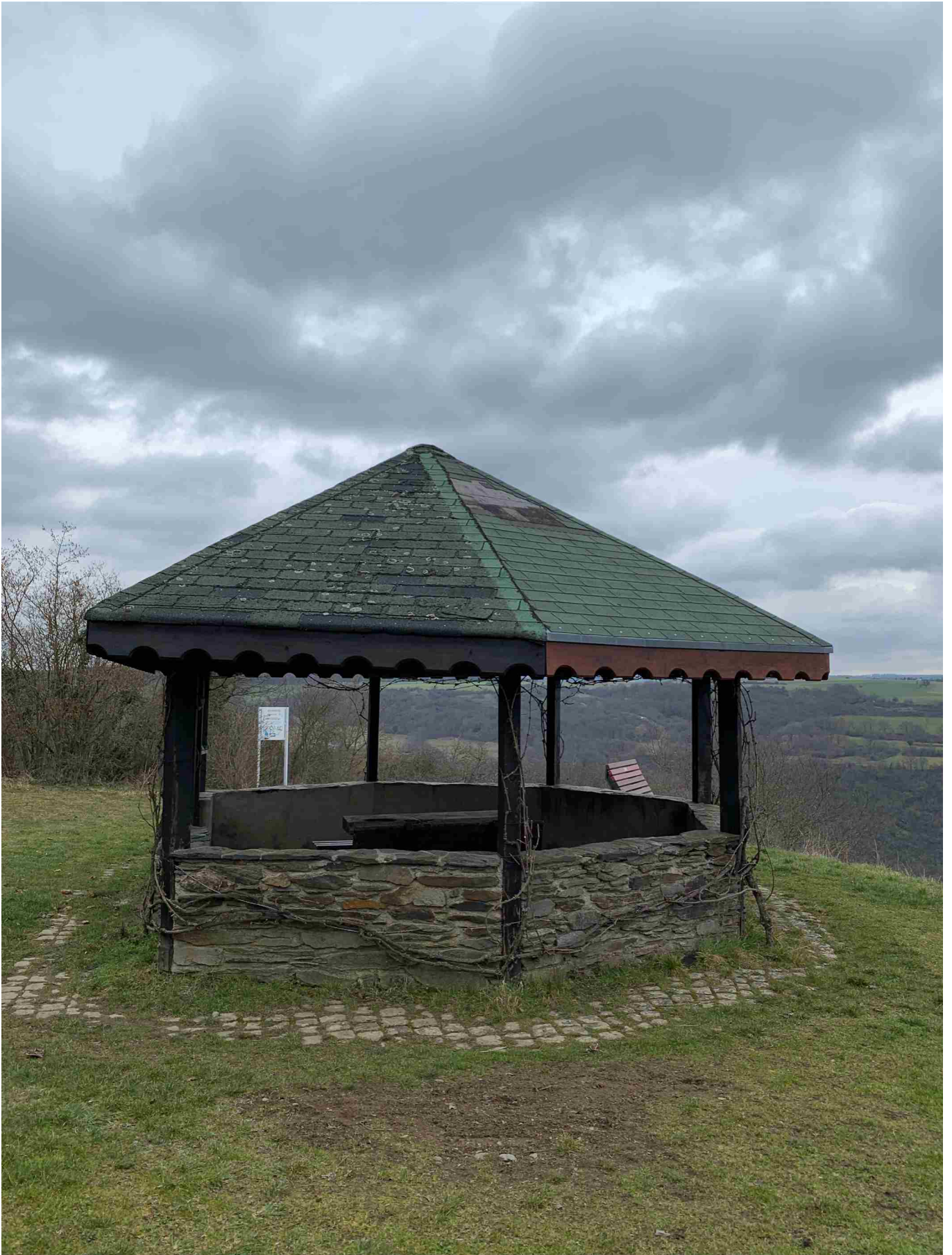
Büttenplatz Hütte - Dach aktueller Zustand
